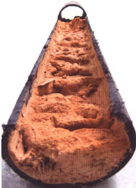
Kalkablagerung im Abwasserrohr
